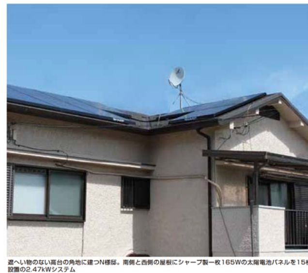
夏へい物のない高台の角地に建つN様邸。南側と西側の屋根にシャープ製一枚165Wの太陽電池パネルを15枚設置の2.47kWシステム
